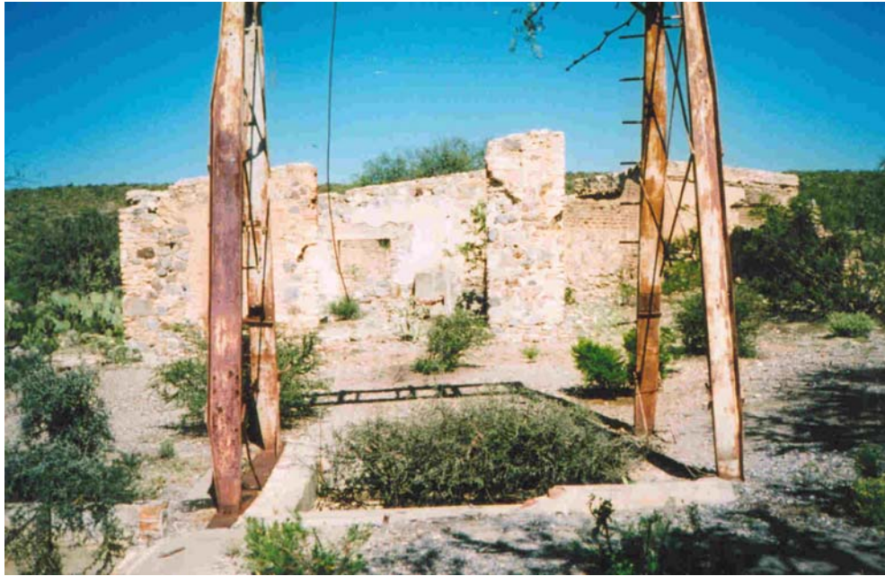
Fotografía 30. Instalaciones de la mina El Marín abandonadas y deterioradas
